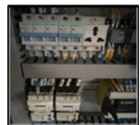
Contactores y corta-circuitos marca Schneider
