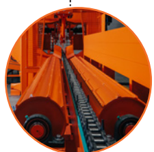
Alimentación del material Conveyor con inverter
